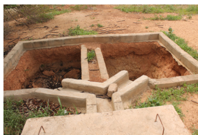
Les fosses du biodigesteur
