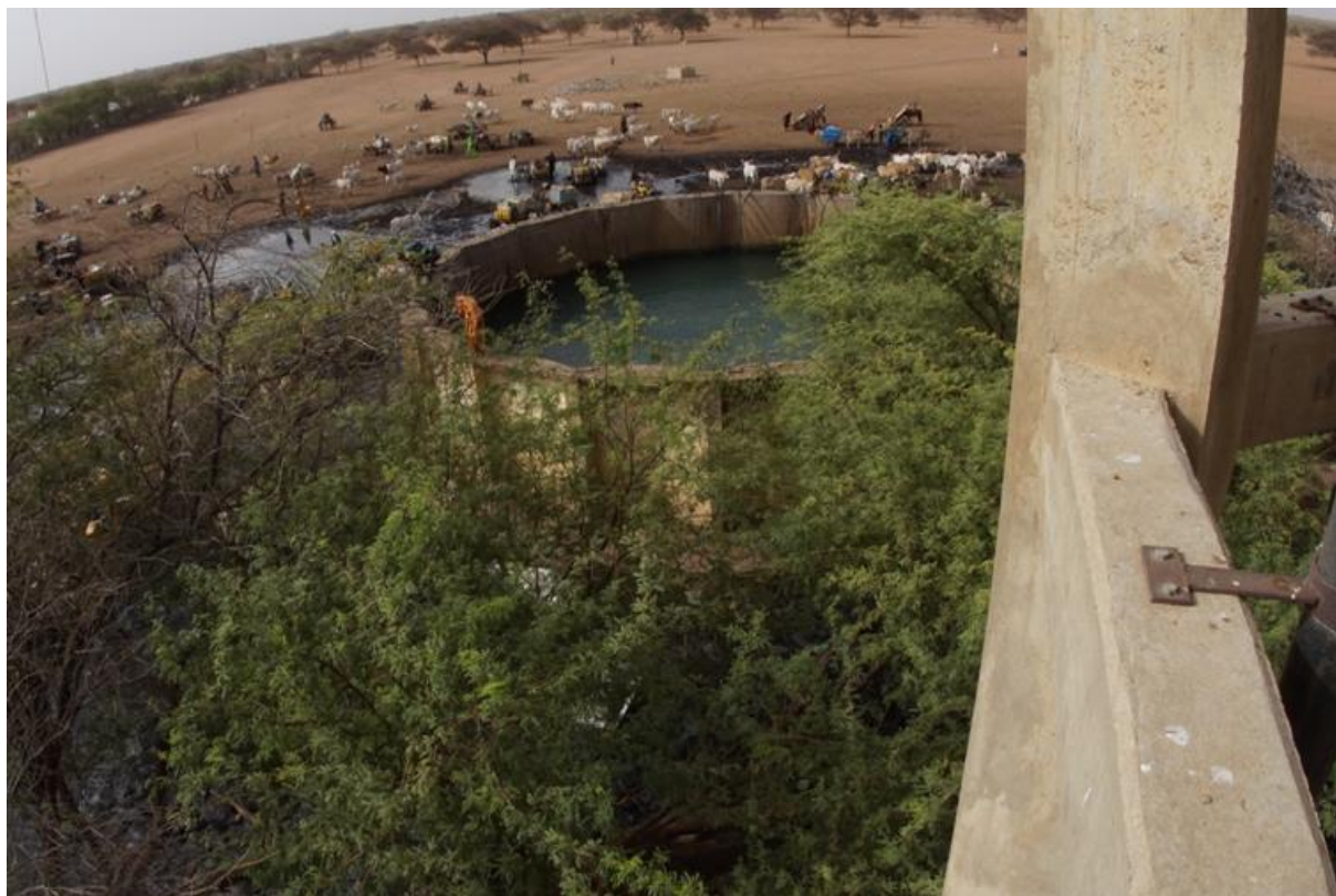
Vue d'en haut de la citerne recueillant et stockant l'eau au forage
